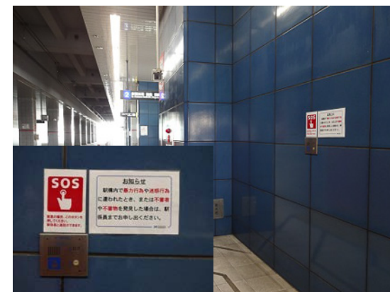
インターホン・緊急連絡押しボタン
