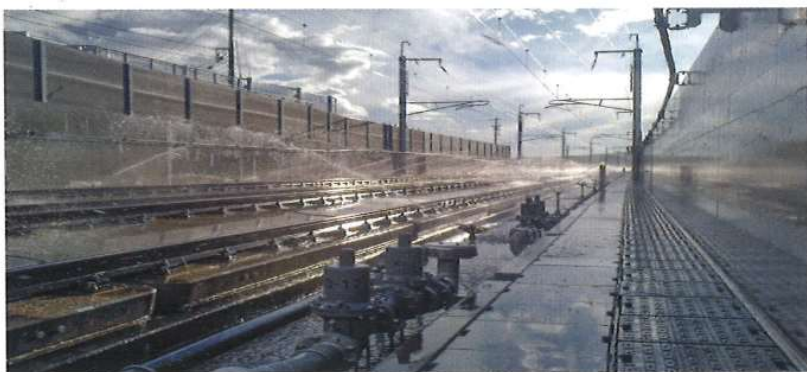
新幹線用消雪・減圧ユニットの第二世代が敷設された東北新幹線青森延長区間
